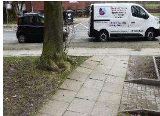
Belagsanhebungen im Gehweg
