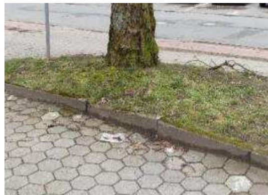
Bordstein- und Belagsanhebungen
