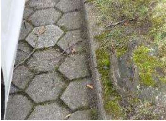
Belagsanhebungen und freiliegende Wurzel
